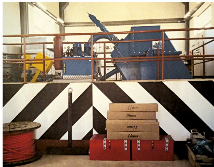
Il sistema della Centrale di Lugarawa
