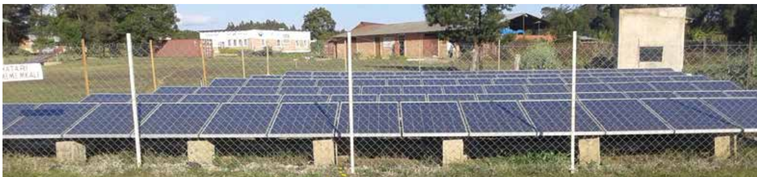
Il nuovo impianto di pannelli solari del Saint Joseph Hospital
